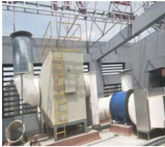
实验室 6#废气排口
