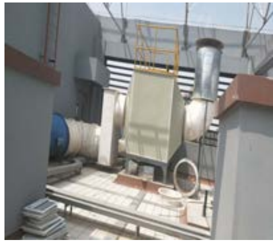
实验室 7#废气排口
