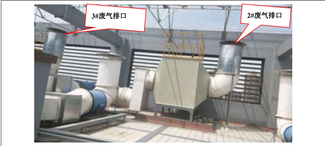
实验室 2#、3#废气排口
